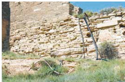
FOTO_ Tony Alcántara Tram del cablejat afectat
